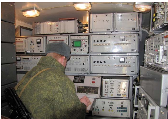
Wnętrze stacji łączności satelitarnej R-440
