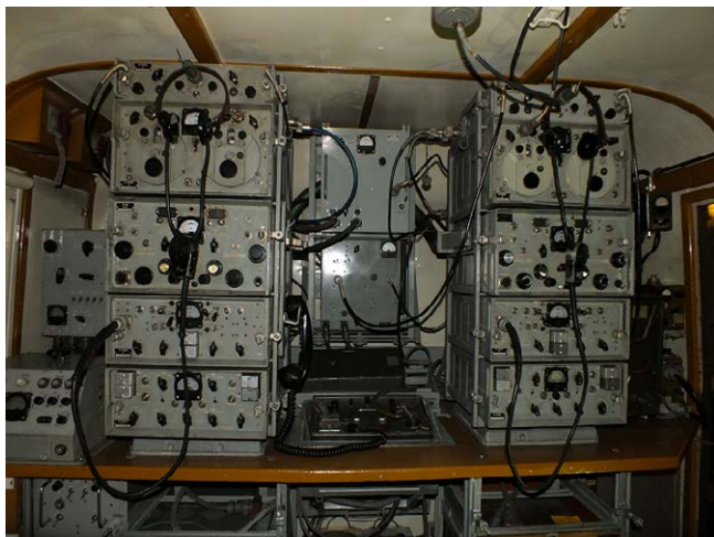
Półkomplety radiolinii R-405Z wewnątrz aparatuwni RWŁ-1M
