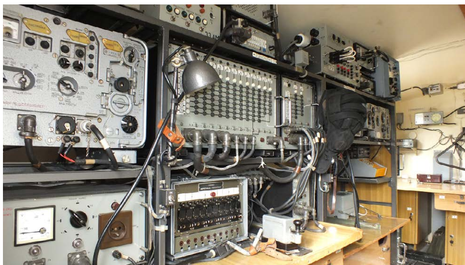
Wnętrze aparatowni ADK-11
