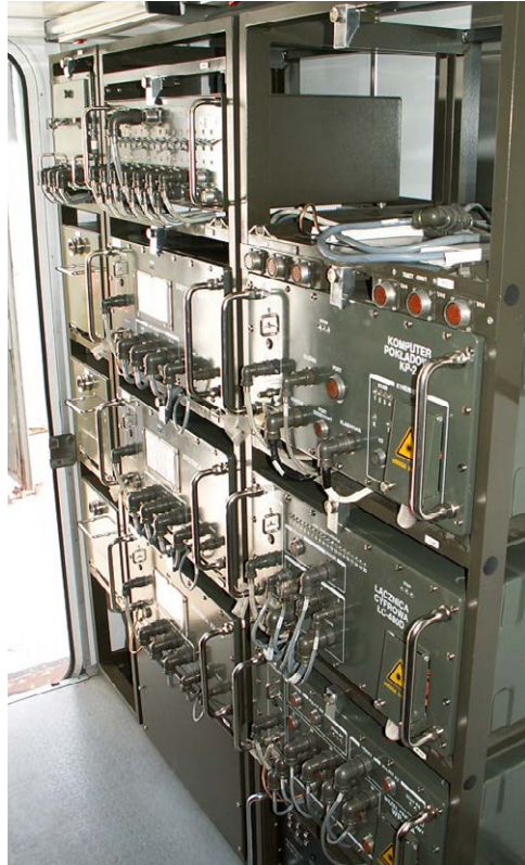
Wnętrze RWŁC-10/K (ściana lewa)
