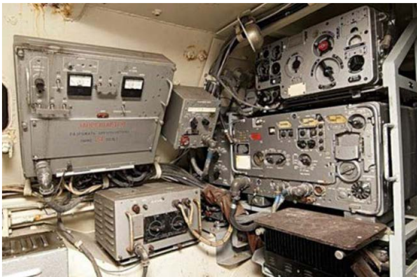
Stanowisko radiotelegrafisty (od lewej: tablica rozdzielcza zasilania, pulpit łączności wewnętrznej PWS-1, prostownik sieciowy WS-27, radiostacja R-123M, radiostacja R-111)
