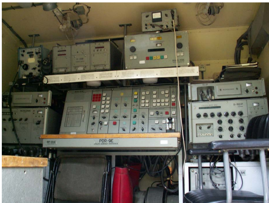
Wnętrze radiostacji R-161AP
