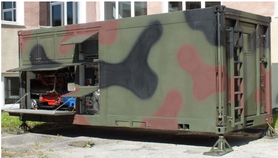
Kontener techniczny z widocznym agregatem prądotwórczym
