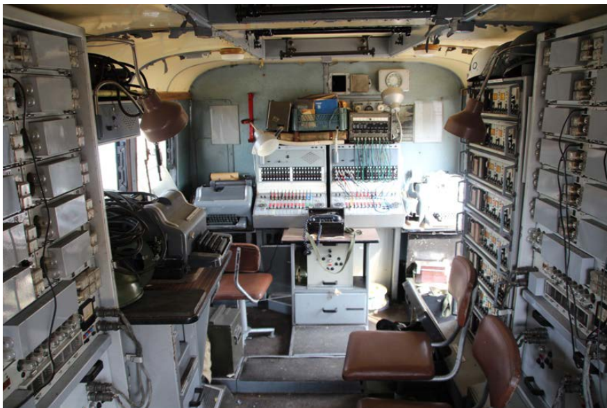
Wnętrze centrali telegraficznej CTgD-80
