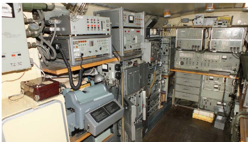
Wnętrze aparatuwni ARO-KU10
