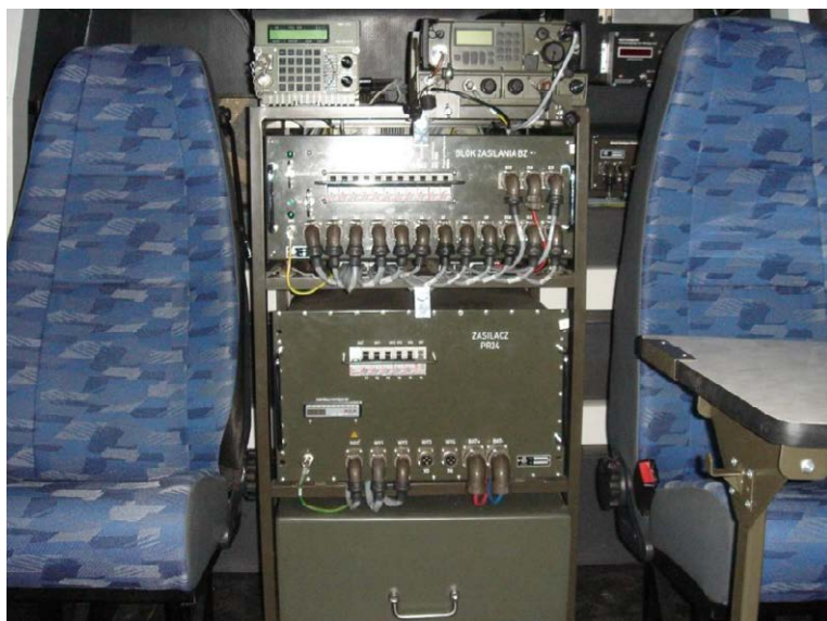
Wnętrze Terenowego Interwencyjnego Wozu Dowodzenia ŻW
