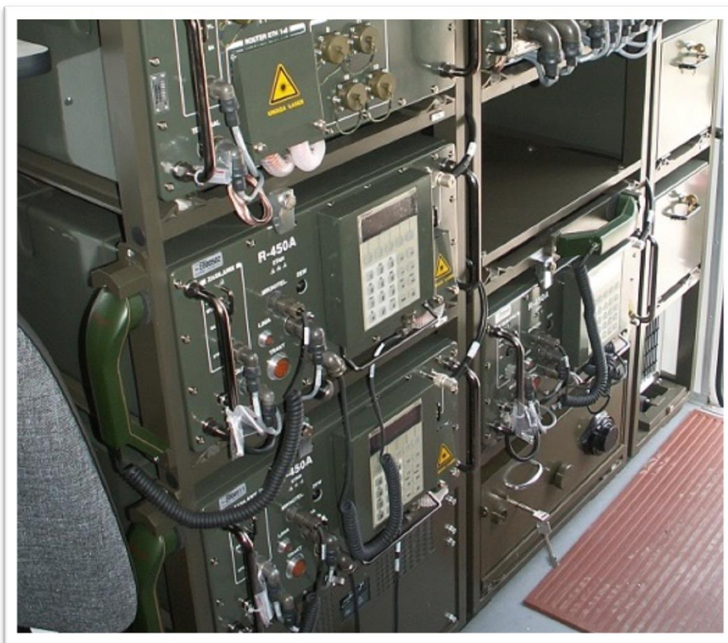
Radiolinie R-450A zamontowane w aparatuwni RWŁC-10/T
