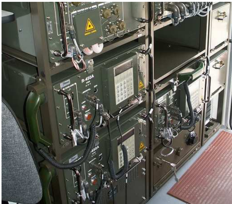
Radiolinie R-450A zamontowane w aparatuwni RWŁC-10/T
