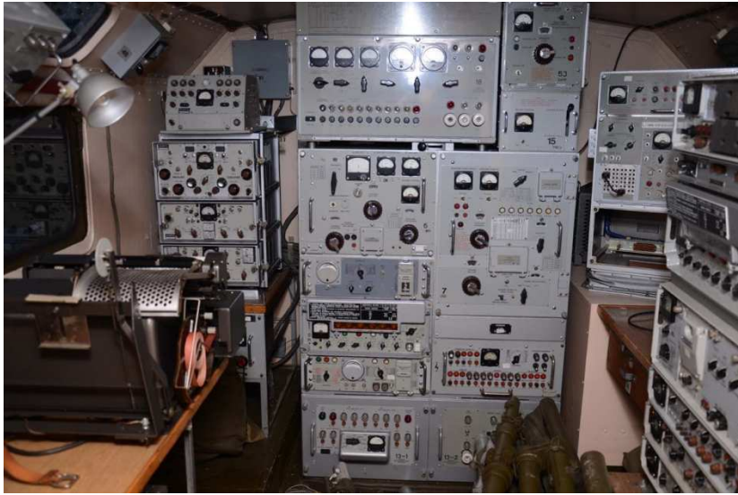
Wnętrze radiostacji R-140
