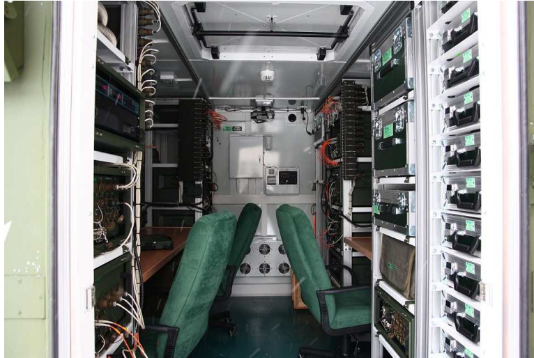
Wnętrze aparatowni ZWT Jaśmin
