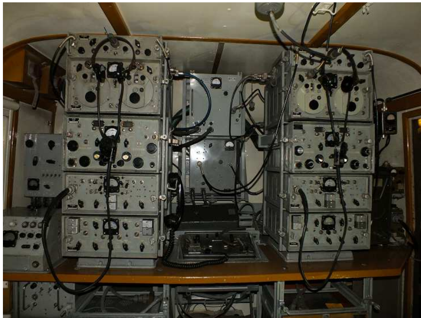
Półkomplety radiolinii R-405Z wewnątrz aparatuwni RWL-1M
