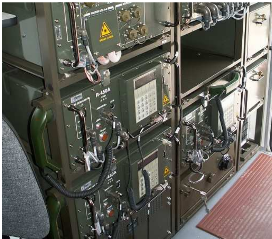
Radiolinie R-450A zamontowane w aparatowni RWŁC-10/T
